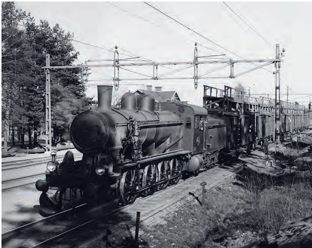
Ett koleldat ånglokomotiv, ett så kallat montagetåg, används för att sätta upp kontaktledningarna under elektrifieringen av Västra stambanan mellan Stockholm och Göteborg.
