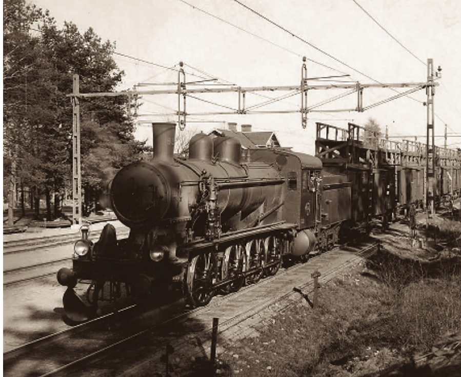
Ett koleldat ånglokomotiv, ett så kallat montagetåg, används för att sätta upp kontaktledningar under elektrifieringen av Västra stambanan mellan Stockholm och Göteborg.
